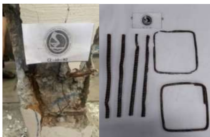
Hình 3.8: Cốt thép cột bị ăn mòn khoảng 22% sau thí nghiệm gia tốc ăn mòn
